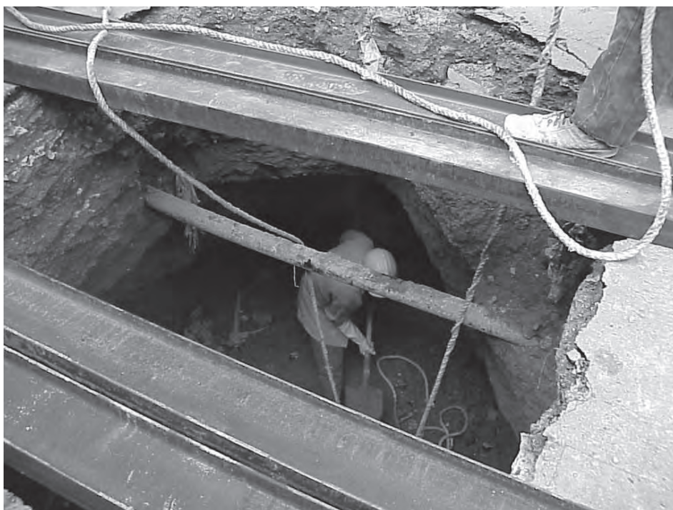
تصویر ۴-۶- ریزش قنات در یکی از محلات جنوبی تهران
