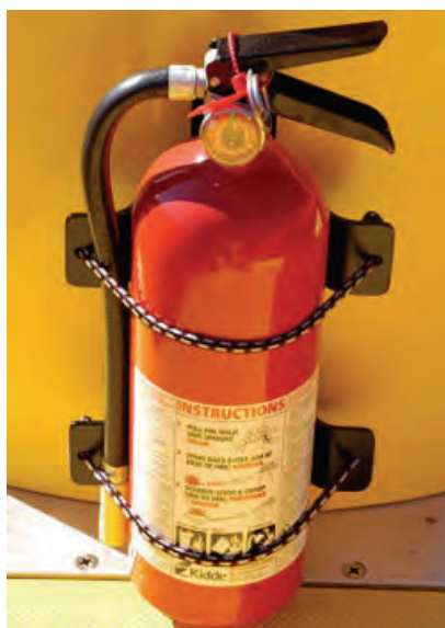
تصویر ۹-۱۲- مهار کپسول اطفاء حریق
